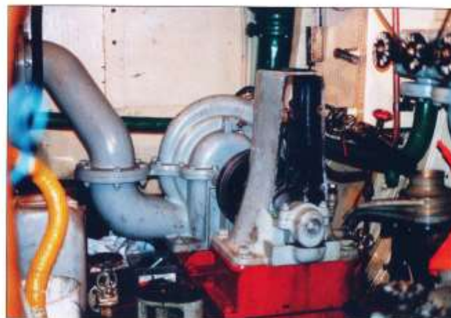
Ångmaskinen som driver kylvattensumpen har renoverats i vinter
